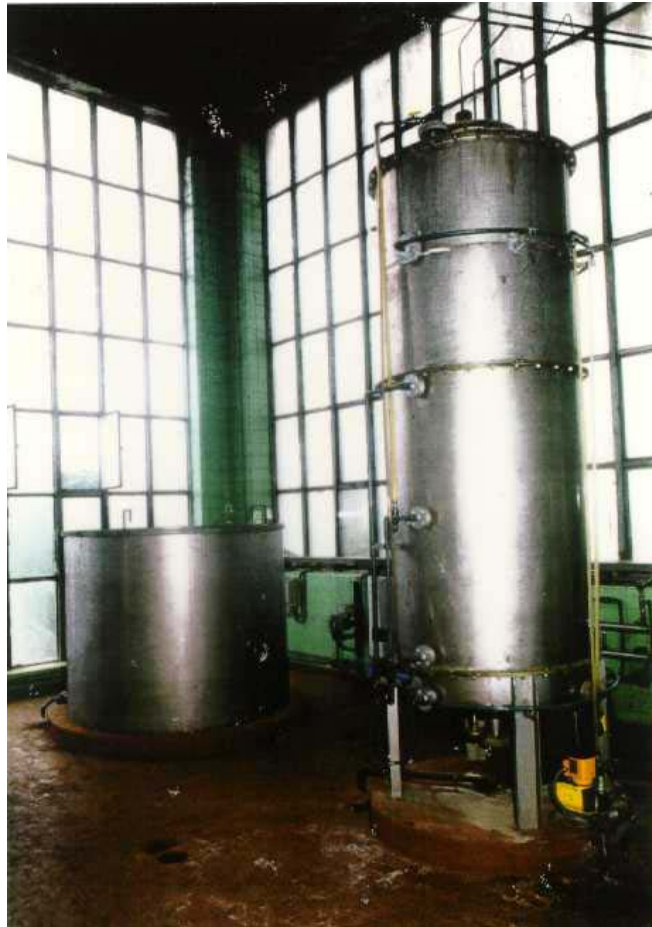
Figura 6.10. Vista do reactor híbrido na planta piloto.
